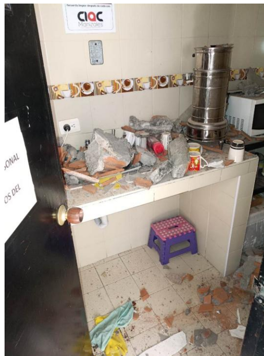
Fotografía 2. Desprendimiento de mampostería y revestimiento, con material sobre el mesón.
