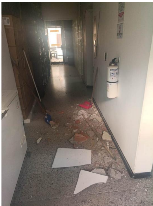
Fotografía 3. Material desprendido en circulación interior.
