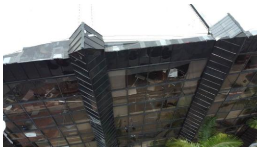
Fotografía 17. Vista adicional de la afectación de fachada en vidrio y acrílico.
