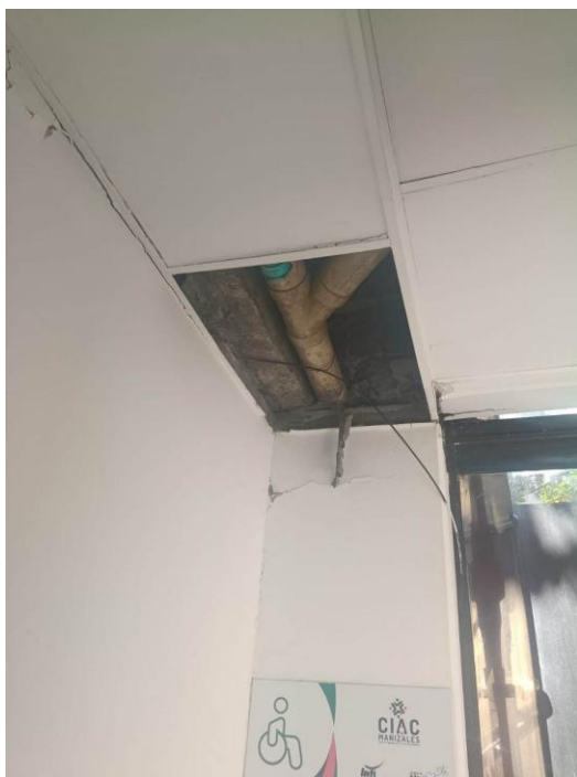
Fotografía 9. Daños en encuentro de muro y ventana y en elementos interiores.
