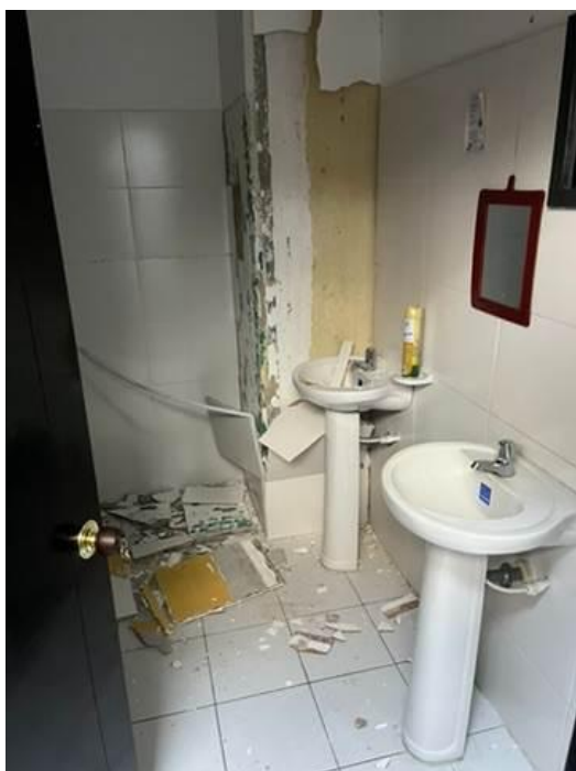
Fotografía 11. Caída de enchape en baños.
