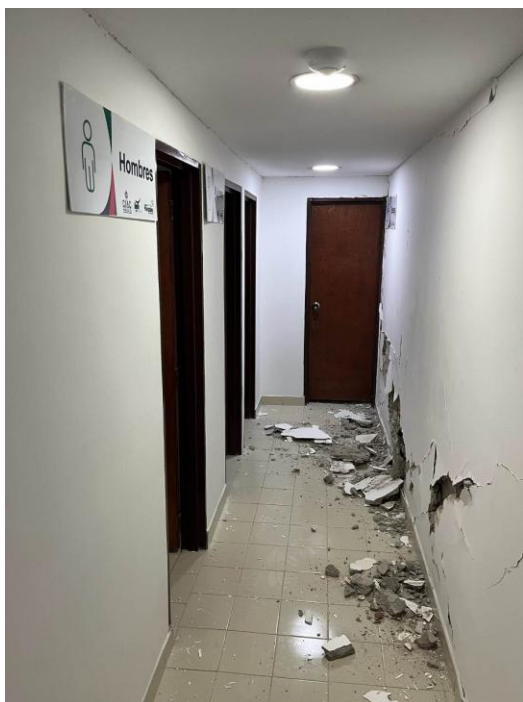
Fotografía 13. Vista adicional de daños y elementos desplazados.
