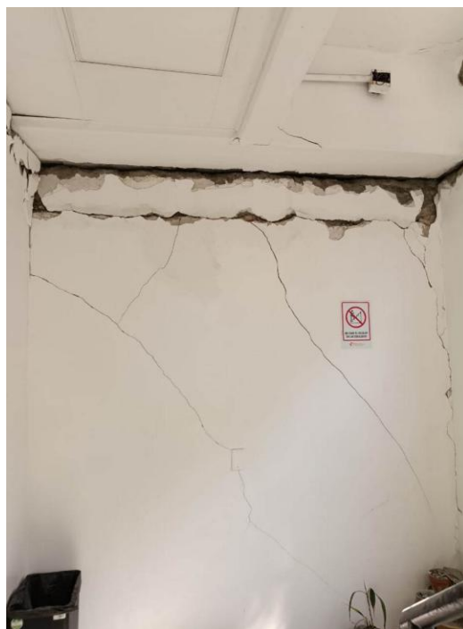
Fotografía 10. Vista adicional de daños y elementos desplazados.
