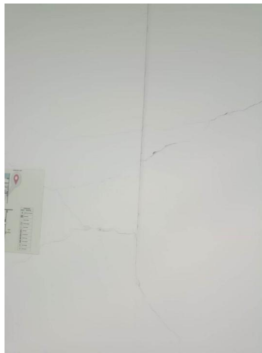
Fotografía 4. Fisuración en muro interior.
