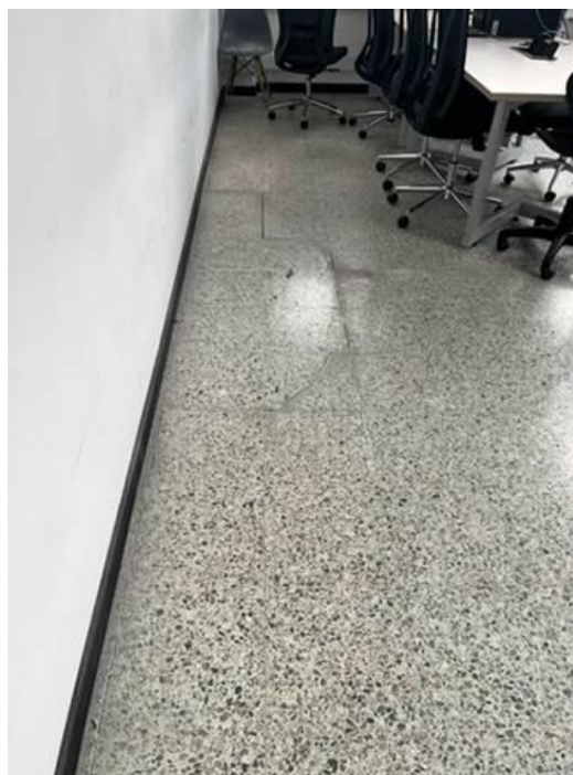
Fotografía 14. Abombamiento del piso en terrazo.
