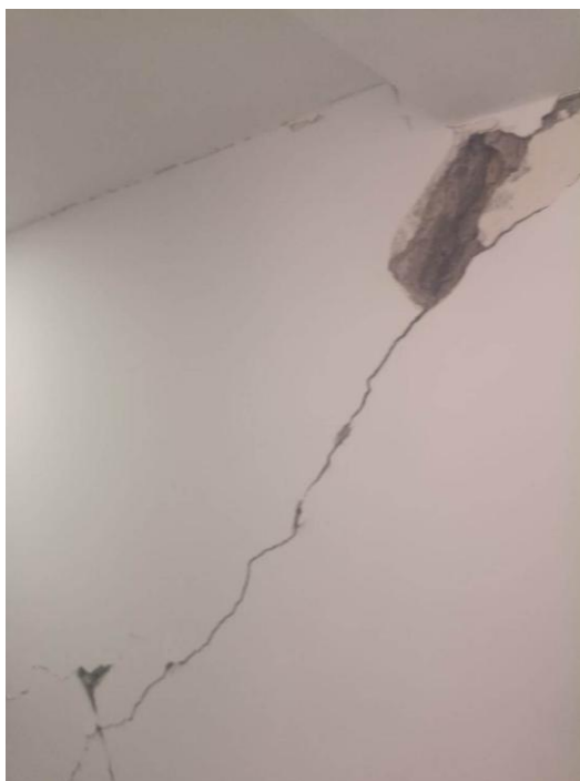
Fotografía 5. Grieta diagonal y desprendimiento localizado en muro.
