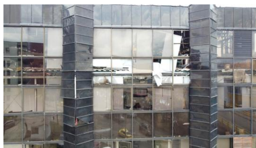
Fotografía 16. Vista adicional de la afectación de fachada en vidrio y acrílico.
