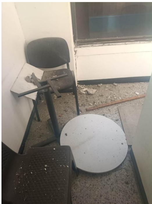
Fotografía 7. Fisuración y pérdida de material en encuentro superior de muro.
