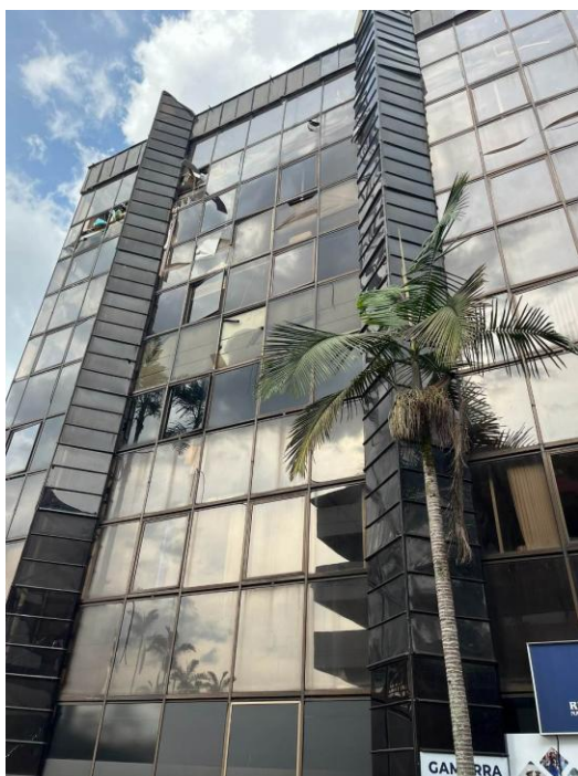
Fotografía 15. Afectación de fachada en vidrio y acrílico.
