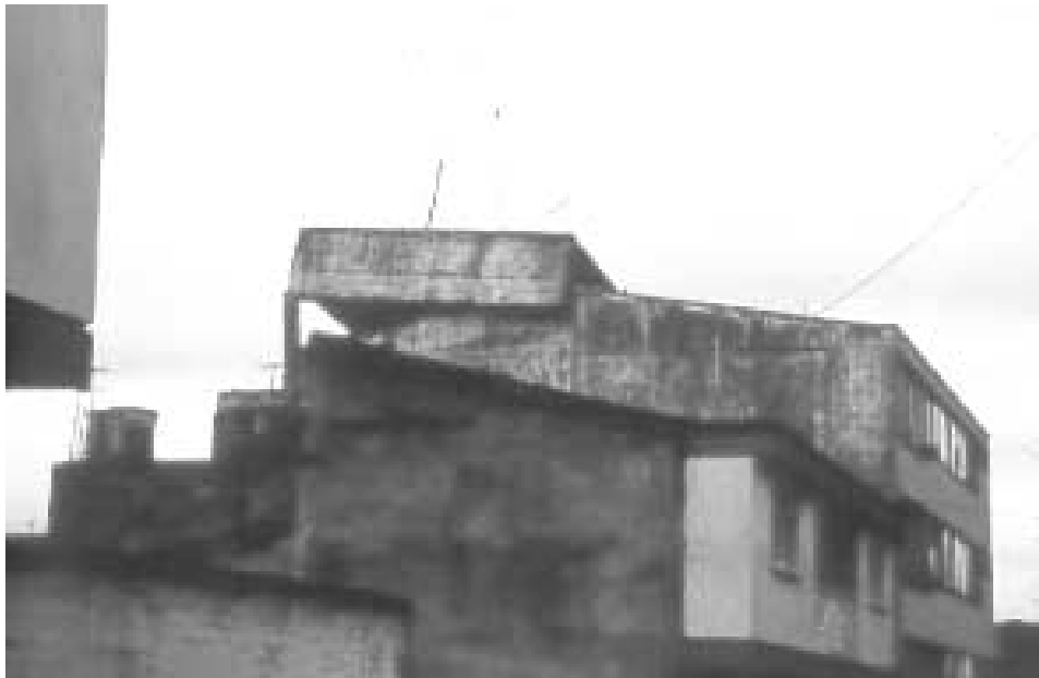
Fotografía. Daños severos en tanques
