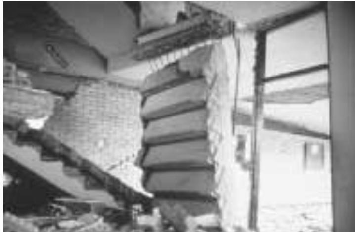
Fotografía. Daño severo en escaleras
