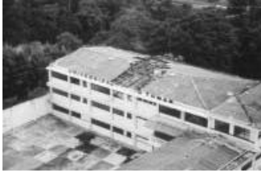
a) Daño nivel Moderado
