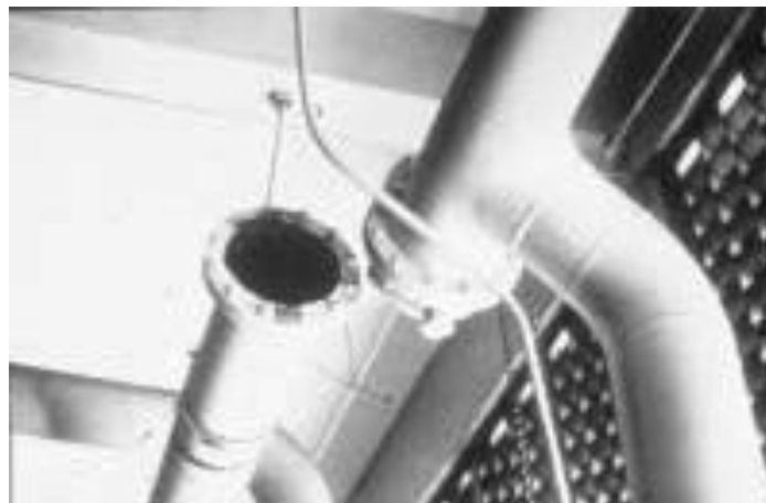
Fotografía. Daños severos en instalaciones
