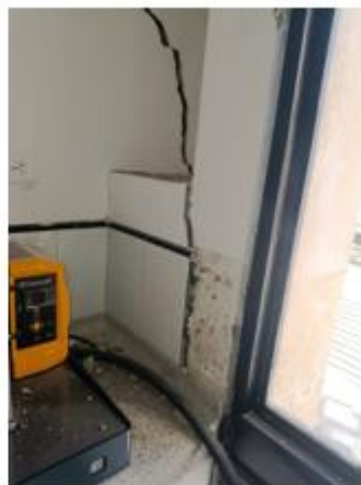
Fotografía 4. Muro divisorio junto a ventana, con grieta pasante generalizada en su altura y desprendimiento de recubrimiento en la base.
