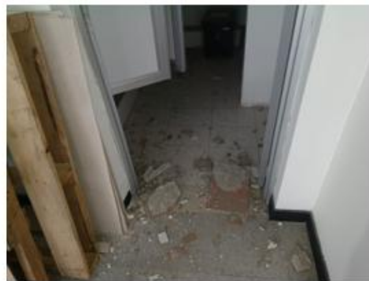
Fotografía 10. Caída de piezas y desprendimiento de revestimiento cerámico del piso, puntual en el umbral.
