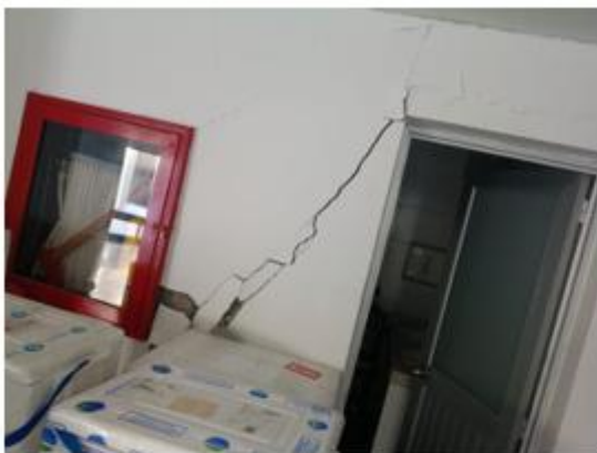
Fotografía 9. Muro divisorio con grieta pasante diagonal en un tramo, desprendimiento de recubrimiento puntual y fisuración irregular superior.
