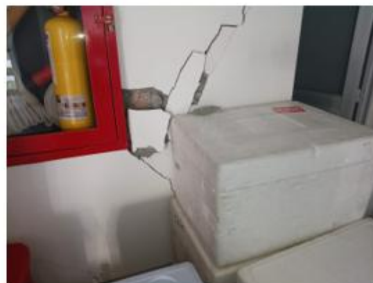
Fotografía 6. Grieta diagonal con desprendimiento de recubrimiento en muro divisorio, en un tramo.
