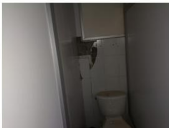
Fotografía 7. Desprendimiento de recubrimiento y caída de enchape en muro divisorio, puntual en el tramo superior.
