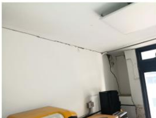
Fotografía 1. Muro de esquina con fisuración diagonal y desprendimiento de recubrimiento. Separación entre muro y placa.
