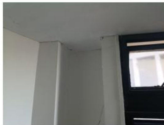
Fotografía 12. Separación generalizada entre cielo raso y muros de esquina. Fisura vertical en muro adyacente.
