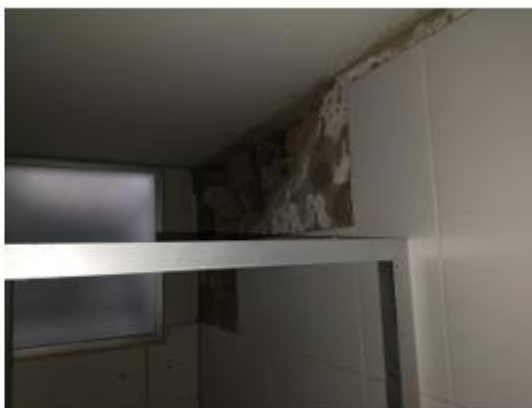
Fotografía 2. Desprendimiento de recubrimiento en la junta entre muro divisorio y cielo raso, en un tramo.
