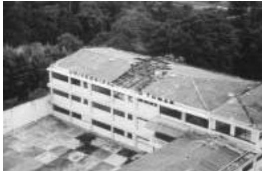
a) Daño nivel Moderado
