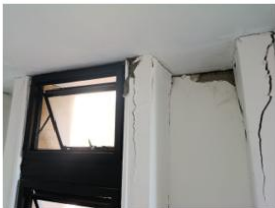
Fotografía 3. Desprendimiento de recubrimiento y fisuración diagonal en muros adyacentes a vano de ventana y encuentro con cielo raso.
