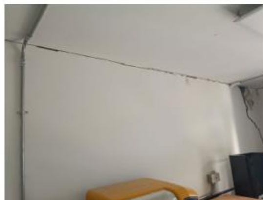
Fotografía 8. Fisura horizontal en la junta de muro con cielo raso, desprendimiento de recubrimiento en la esquina.
