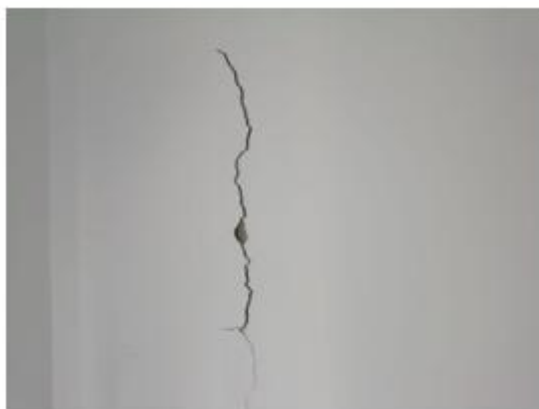
Fotografía 13. Muro divisorio con grieta pasante vertical y desprendimiento de recubrimiento, generalizada en el tramo visible.
