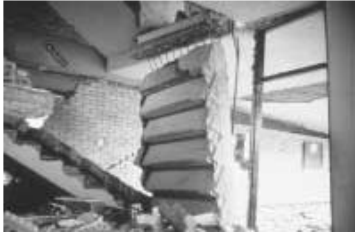
Fotografía. Daño severo en escaleras
