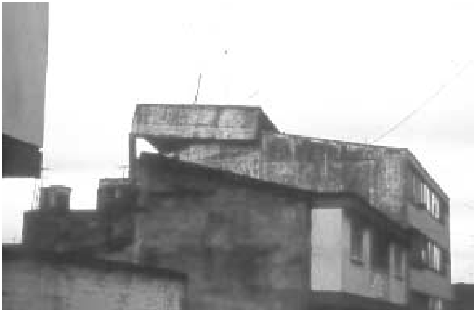
Fotografía. Daños severos en tanques
