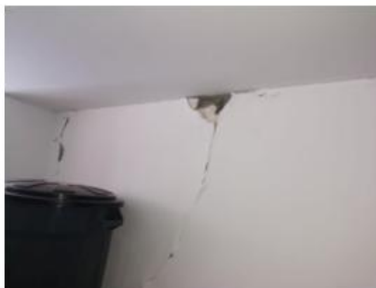
Fotografía 14. Desprendimiento de recubrimiento en la junta de muro con placa de entrepiso, y fisura vertical en el muro.
