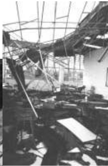
b) Daño Severo
