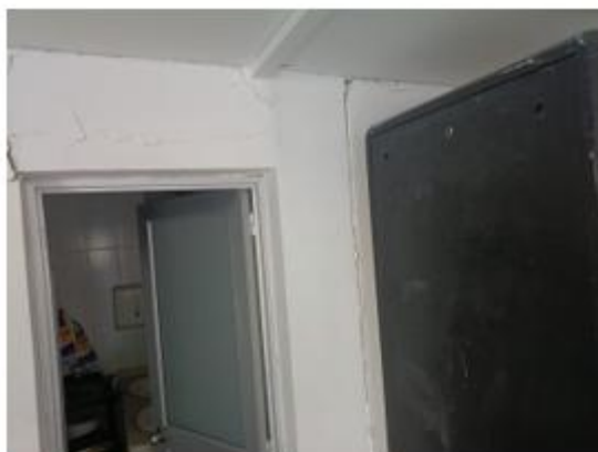
Fotografía 5. Fisuración diagonal en muro divisorio sobre vano de puerta, generalizada. Separación vertical entre muro y mueble adyacente.
