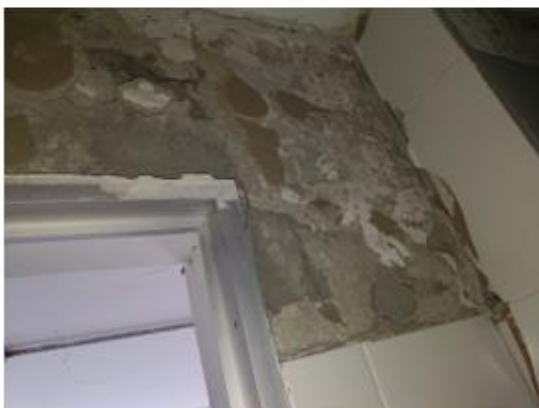
Fotografía 11. Desprendimiento de recubrimiento en muro divisorio sobre vano de puerta, con fisuración diagonal, en un tramo.
